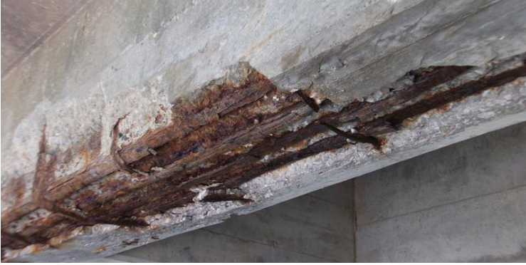
Şekil 1. Betonarme kirişindeki korozyona uğramış çelik donatılar (Beton Yapılarda Korozyonun Etkisi,2016)
